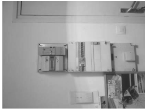
Figure 4-6: le tableau électrique avec l'ancien compteur (à gauche) - mesures de courant électrique CPL Linky et de champ magnétique rayonné dans l'entrée devant le tableau électrique (à droite)
